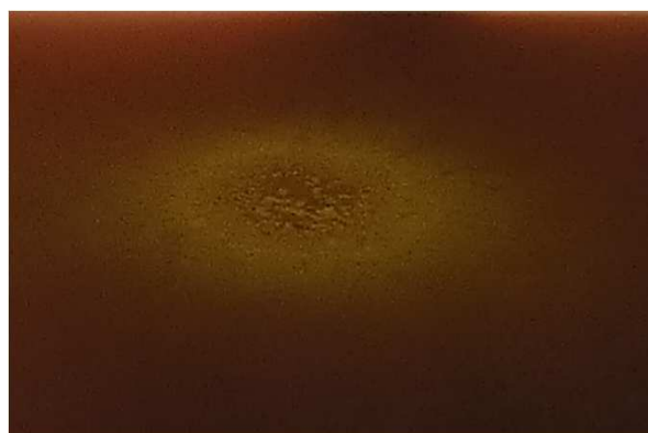
【 耐火煉瓦の焼け跡 拡大写真 】
